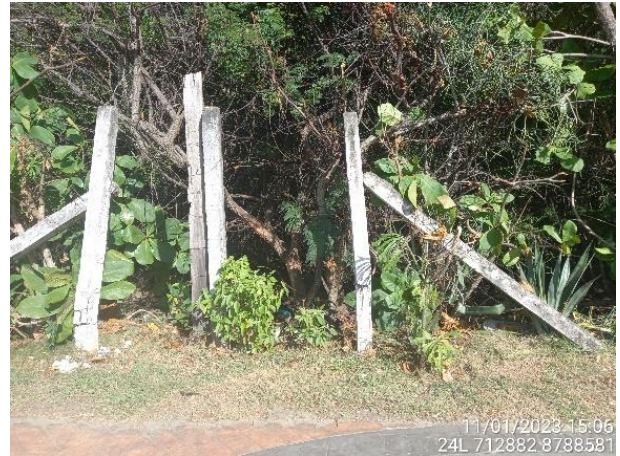
Foto 2-160 - Cerca existente no trecho totalmente danificada.
