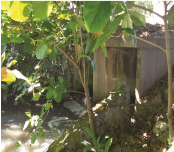
Foto 2-93 - Afluente de esgoto lançado no Ponto 5 evidenciando também a estrutura de concreto da canaleta
